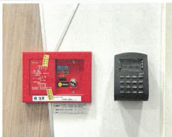
氣體滅火器感應設備
