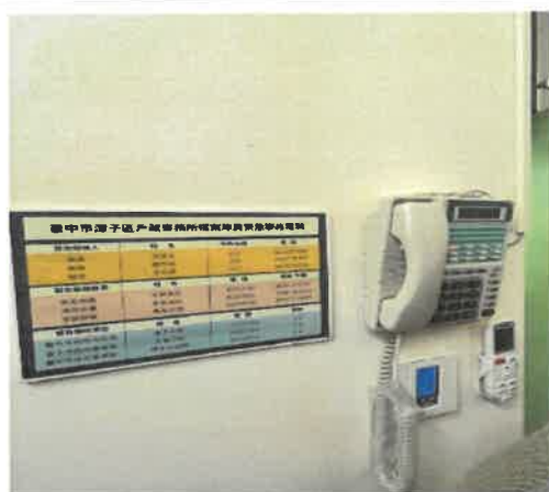
緊急聯絡電話等設備
