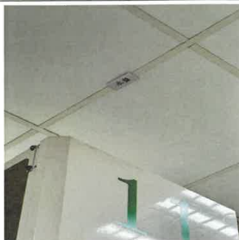
庫房以現有設施改善，標示水盤位置提醒
