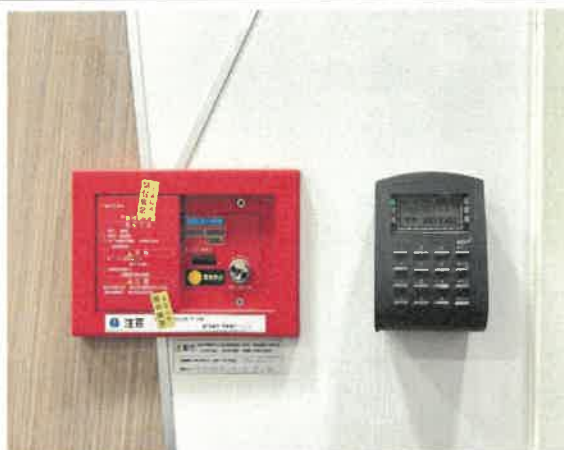
氣體滅火器感應設備
